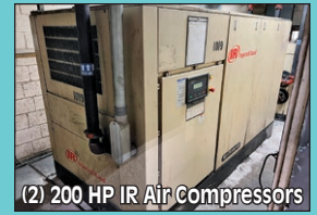
(2) 200 HP IR Air Compressors
