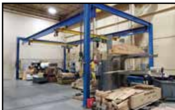
16'W x 25'L x 12'H Bridge Crane
